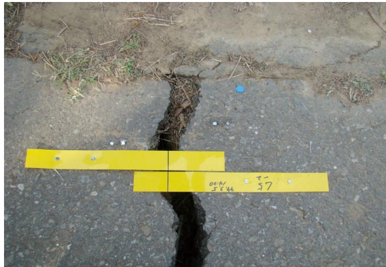
圖3 台南縣虎頭埤水庫因地震產生之裂縫。
