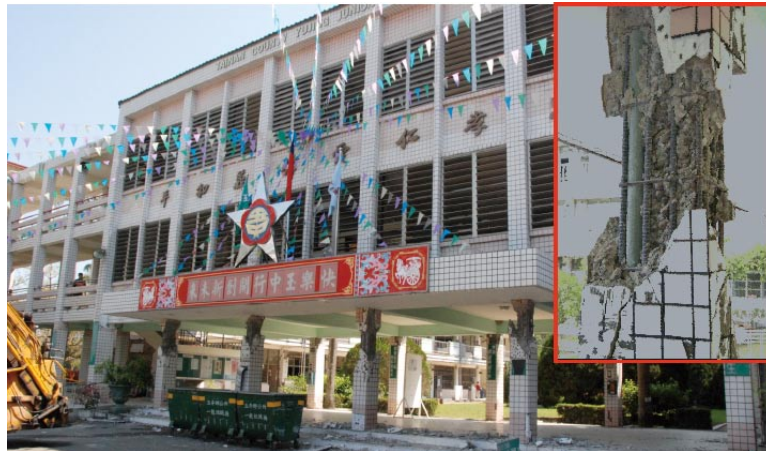
圖2 玉井國中校舍實際損傷情形。
